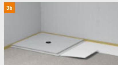
Variante B: Um auf die Höhe des Stufenfalzes vom Duschelement zu kommen, wird über die Fläche 10 mm dicker Dämmstoff (EPS DEO 150) verlegt
